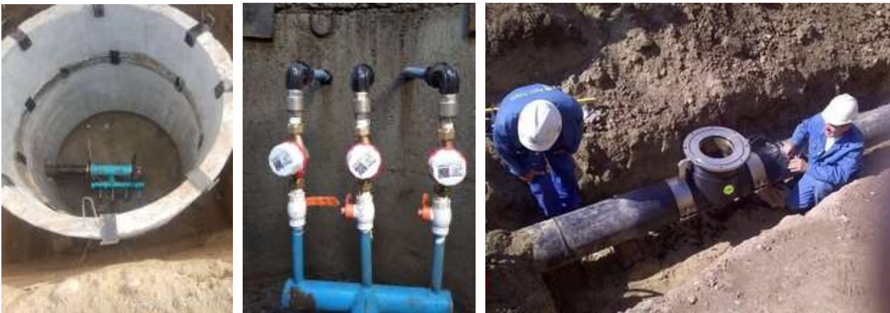
Рисунок 14. Примеры работ на участках подпроекта - Распределительные сети
