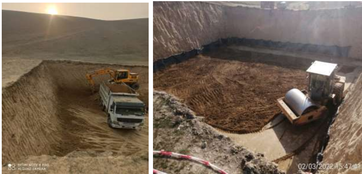
Рисунок 10: Примеры работ на участках подпроекта - поперечное сечение траншеи, глубина котлованов, регламентируется проектом
